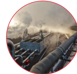
Te Mihi Stage 2 Geothermal
